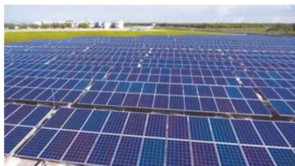
Fig. 4.8. Planta Fotovoltaica del IDAC
